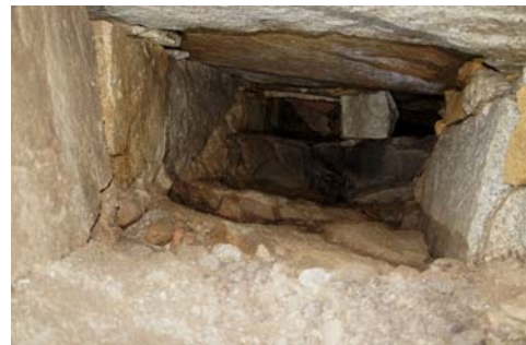
Cámara de unión de los tramos pequeños con el ramal principal de la alcantarilla. Plaza de la Constitución
